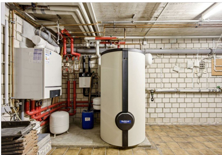
Haus-Nr. 62 - Keller - Heizung
