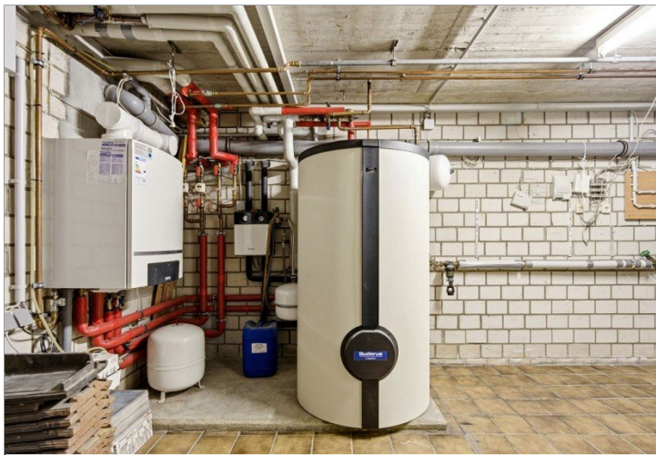
Haus-Nr. 62 - Keller - Heizung
